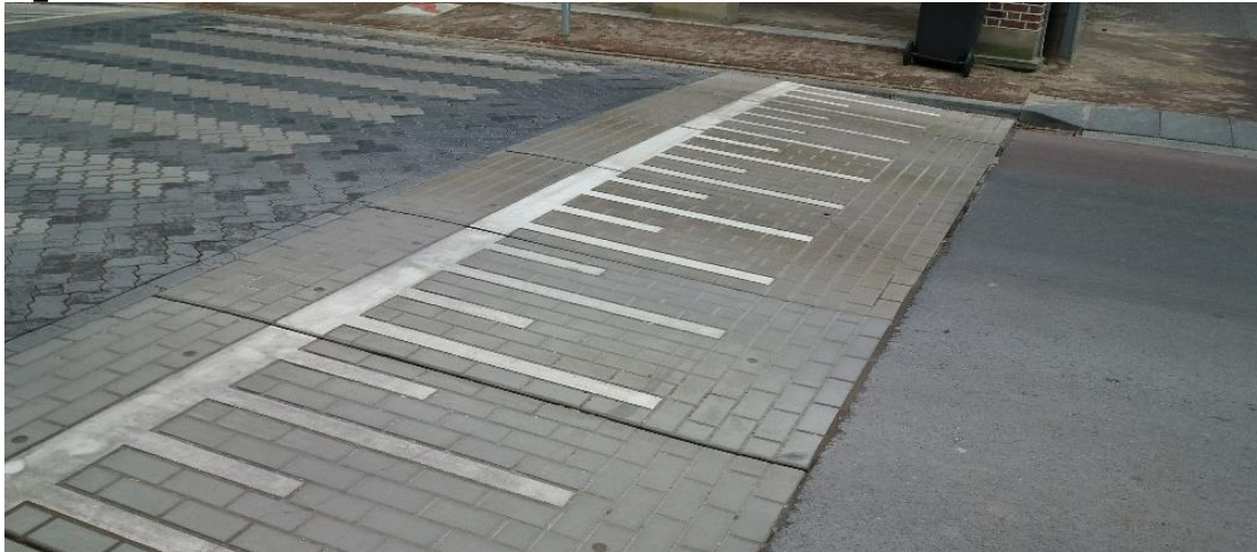
Toepassing verkeersafremming door verkeersdrempels van De Hamer.
